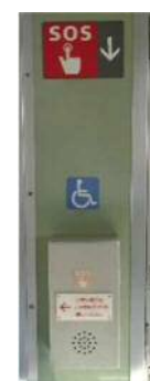
非常通報装置 2
