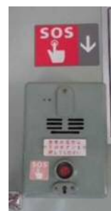
非常通報装置 1
