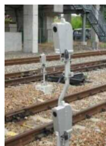
踏切障害物検知装置
