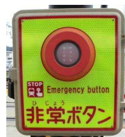
踏切支障報知装置
