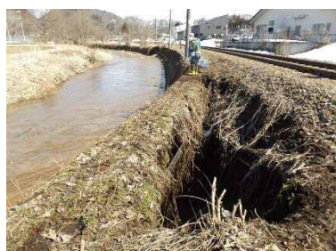
洗掘により陥没した線路脇
